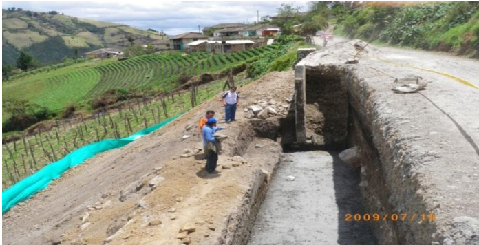
Vía Puerres – San Mateo, Obra de contención KM 5 + 200, (Vereda las Tres Cruces)
